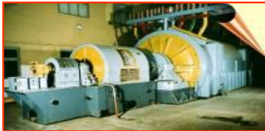
Генератор тока 100кА
