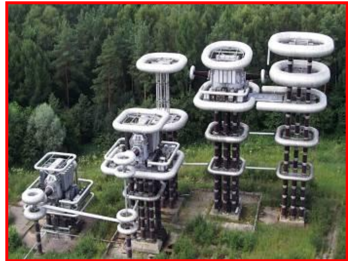
Каскад трансформаторов на 3,2МВ
