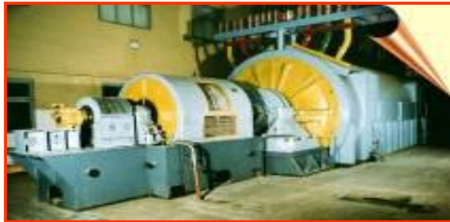
Генератор тока 100кА
