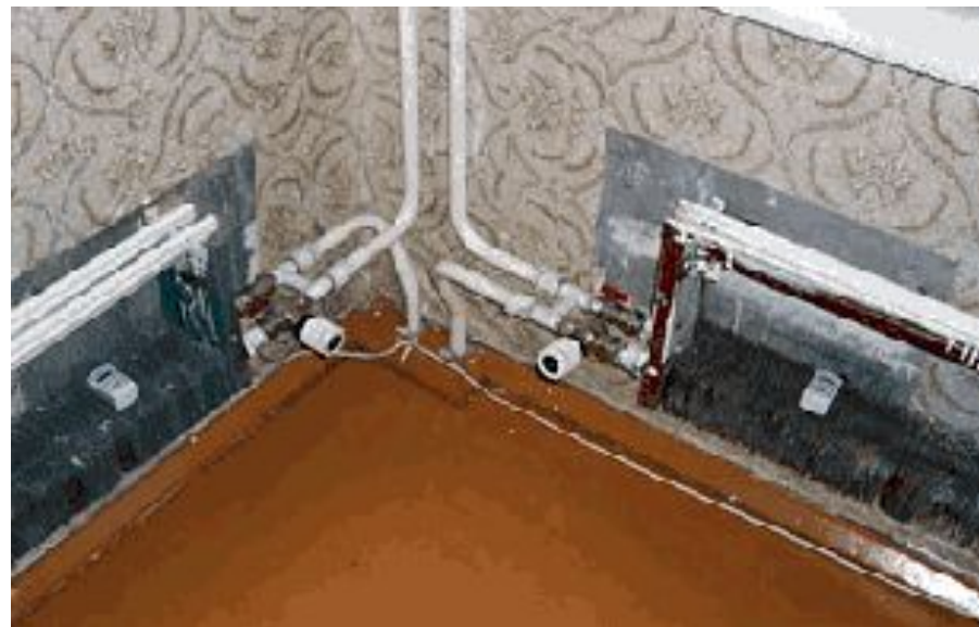
Пример установки распределителя расхода тепла на конвектор
