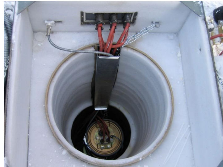
Колодец монтажного модуля
