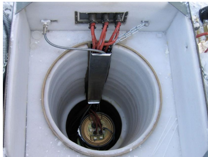
Колодец монтажного модуля
