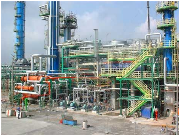
Установка производства серы на заводе Total в г.Гавр (Франция)
