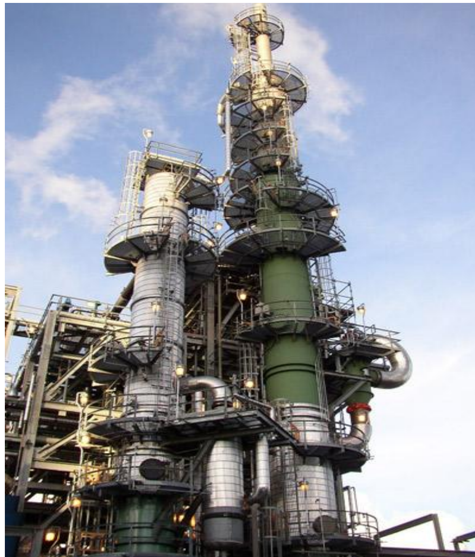
Установка концентрирования диоксида серы на медеплавильном заводе в г.Легница (Польша)
