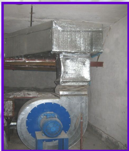
Теплообменник-утилизатор «сброного» тепла вентвыбросов
