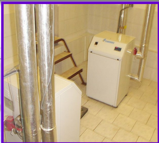
Тепловые насосы энергоэффективного дома в Москве
