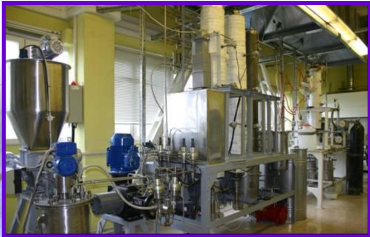
Когенерационная энергоустановка КЭУ-10
