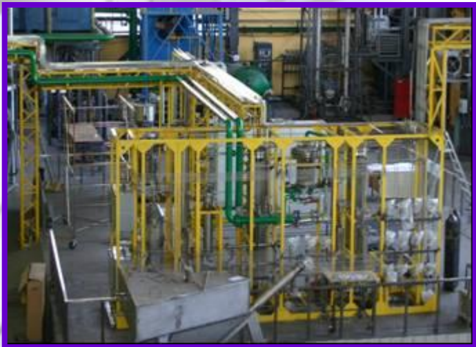
Энерготехнологический комплекс ЭТК-100
