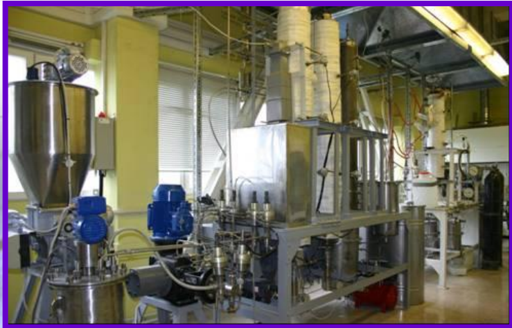
Когенерационная энергоустановка КЭУ-10
