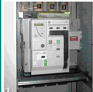
Устройства с большой массой установлены на монтажной раме
