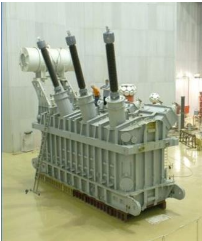
Силовой трансформатор 630 МВА 330 кВ Самый мощный трансформатор в России
