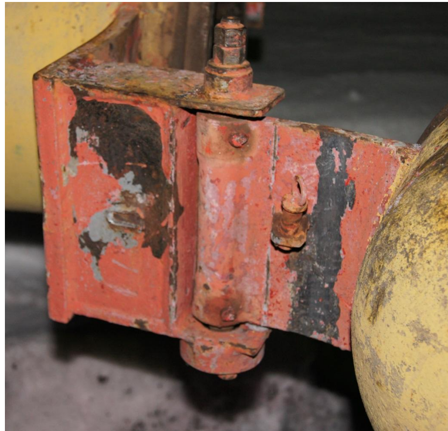
Повреждения на запорном устройстве камеры
