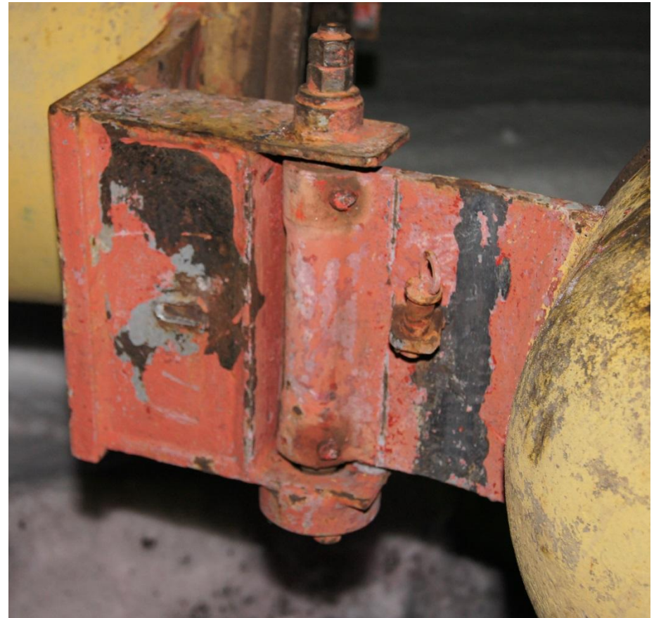
Повреждения на запорном устройстве камеры
