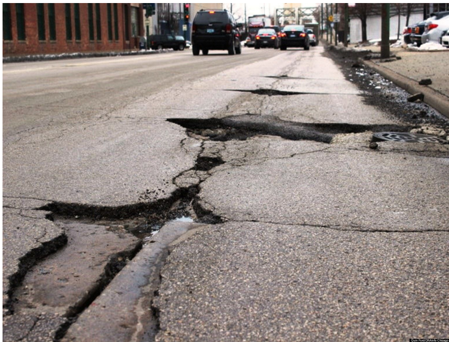
Плохое качество дорожного покрытия
