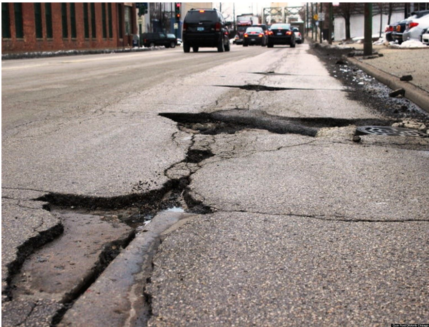
Плохое качество дорожного покрытия
