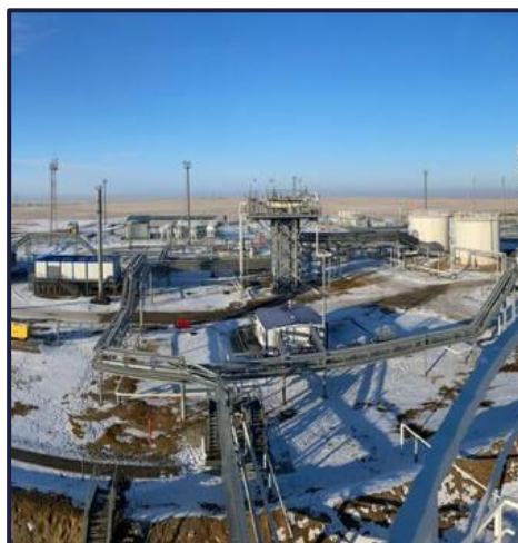
Дожимная-насосная станция (газопровод)
