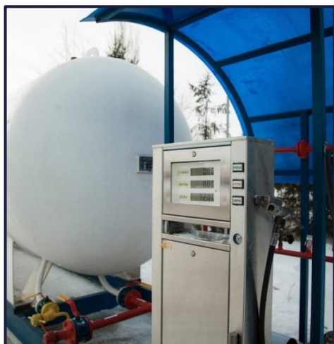
Газ толтыру станциясы
