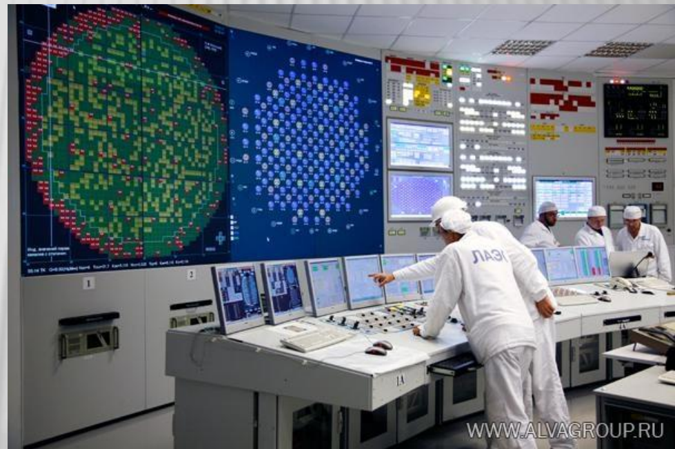
Ленинградская АЭС. Блочный щит управления
