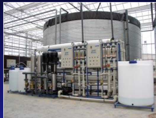
Установка обратного осмоса 30 м 3 /ч
