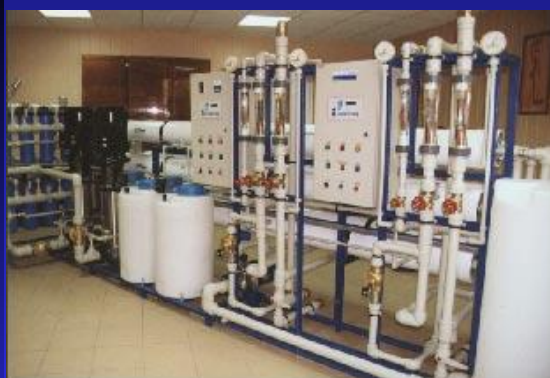
Установка обратного осмоса 20 м 3 /ч
