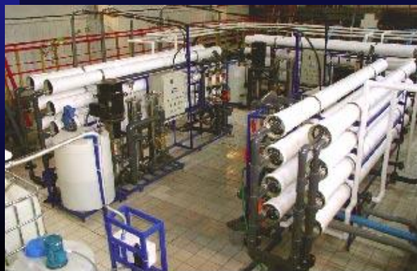
Установка обратного осмоса 100 м 3 /ч
