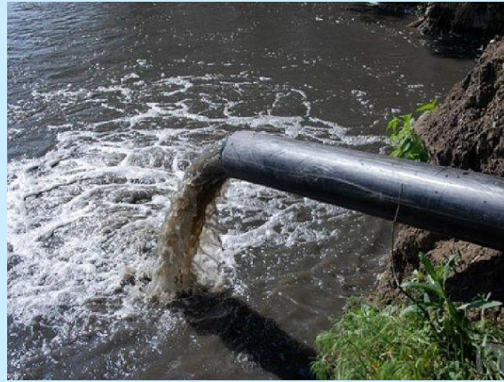
Канализационные стоки с. Стройкерамика в р. Падовка
