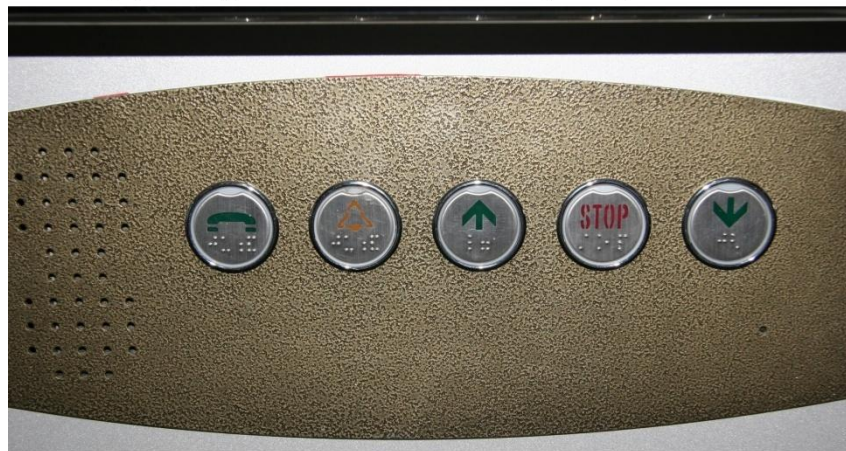
Кнопочный пост управления на платформе
