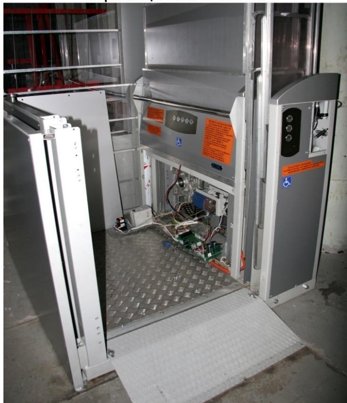
Общий вид с открытой крышкой шкафа привода и электрооборудования
