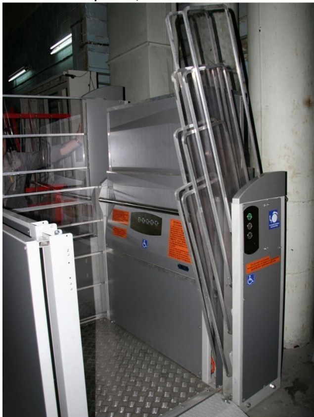
Общий вид с открывающимся шлагбаумом
