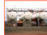
Хранилища жидкого топлива
