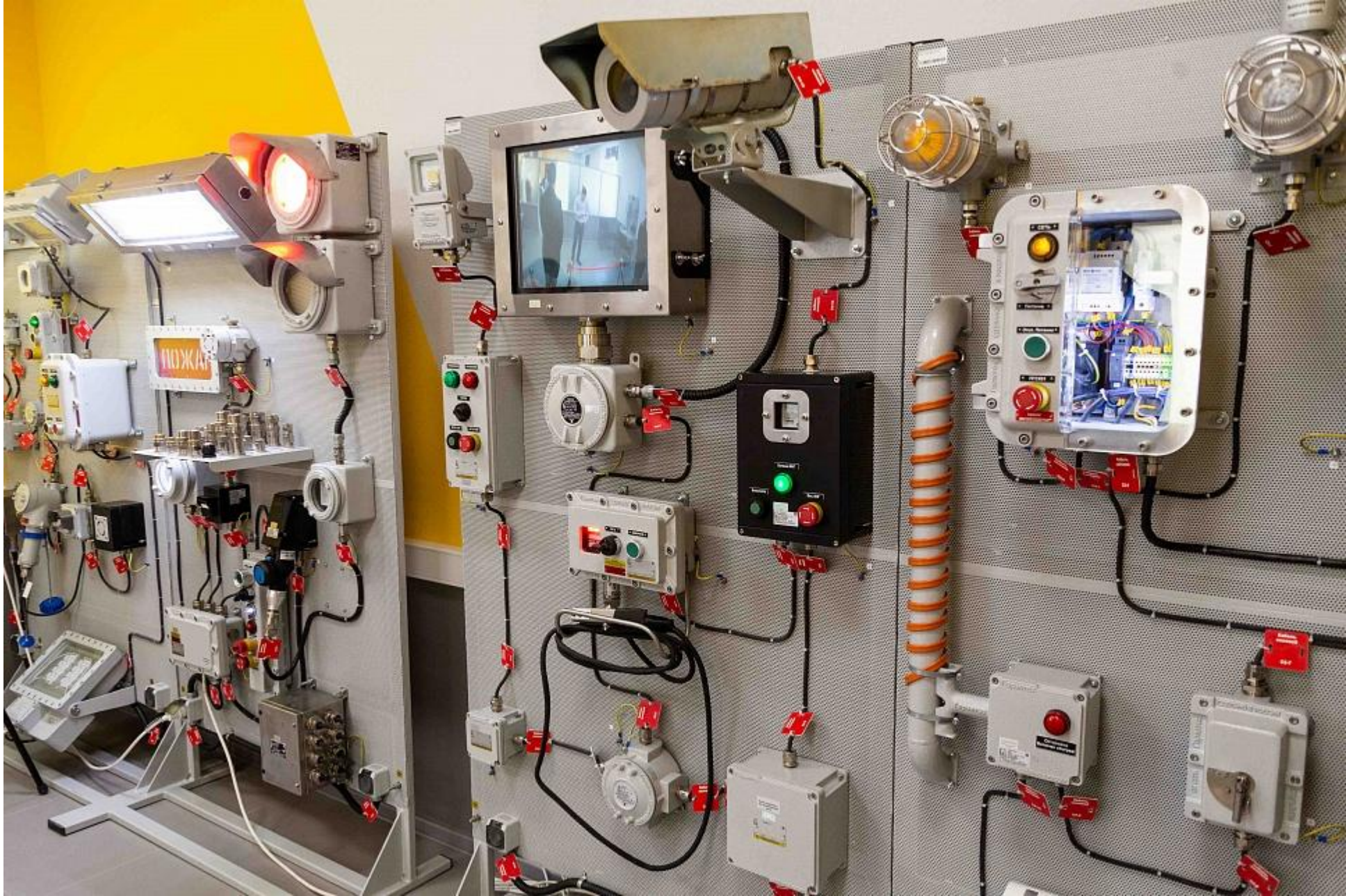
Панель управления и мониторинга с оборудованием в исполнении
