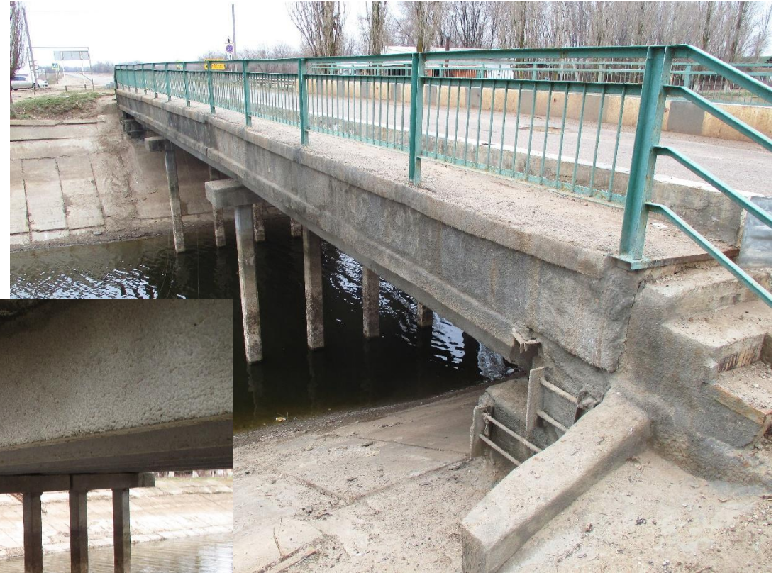
Спустя 3 года после ремонта
