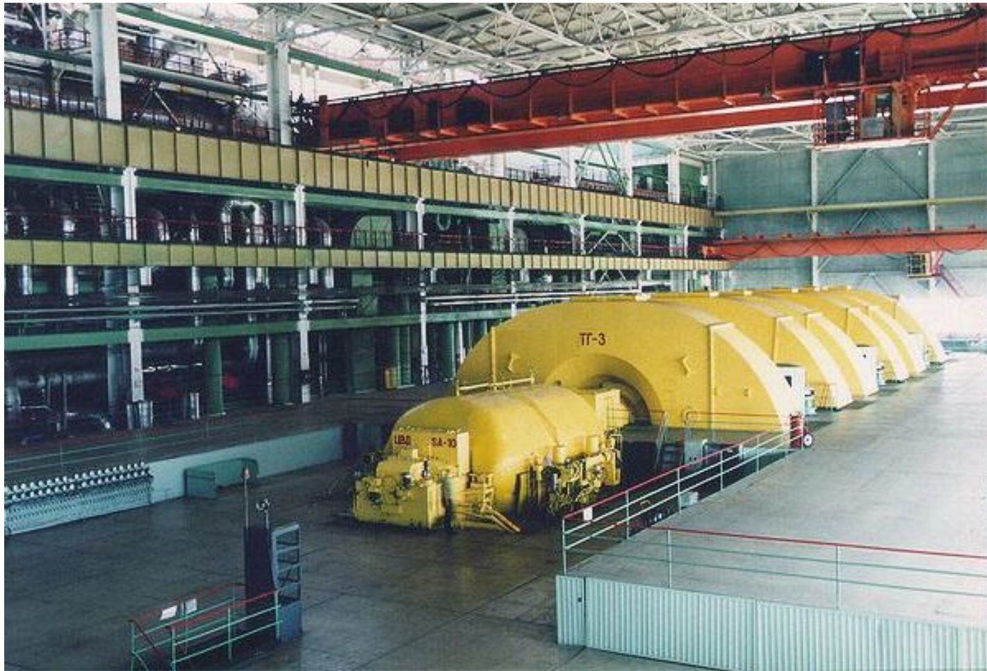
Турбогенератор Запорожской АЭС
