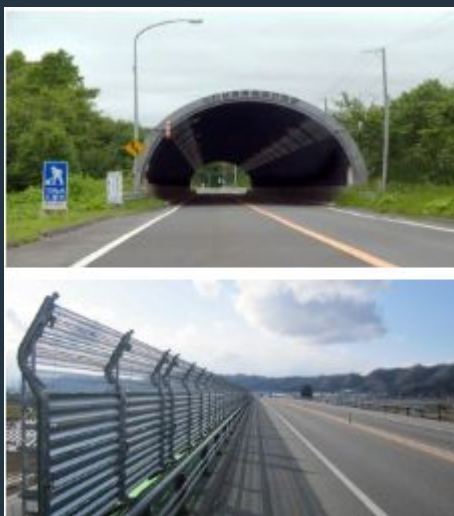
Снегозащитная галерея и ограждение
