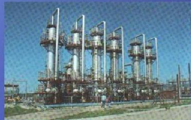
Установка для очистки и осушки газа
