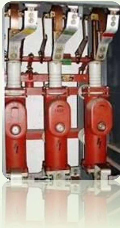
Рис. 3. ОБЩИЙ ВИД масляного выключателя ВМГ-10
