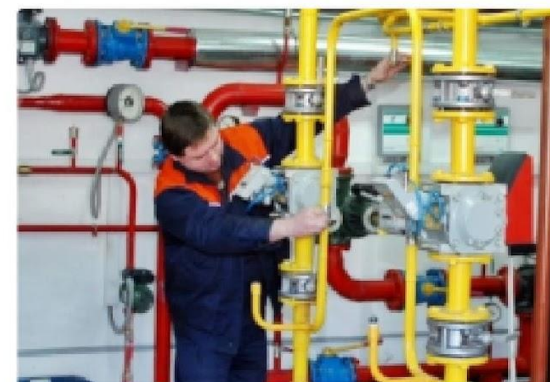
Обслуживание инженерных систем
