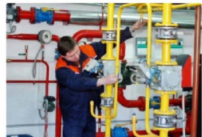
Обслуживание инженерных систем
