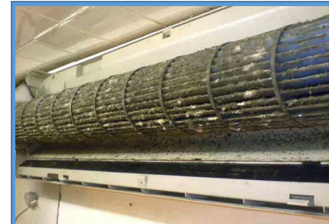
Пример не эффективного теплообменника
