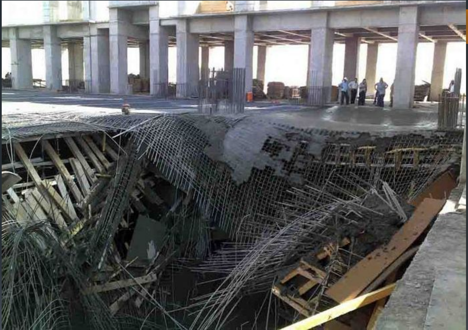
Обрушение монолитного перекрытия
