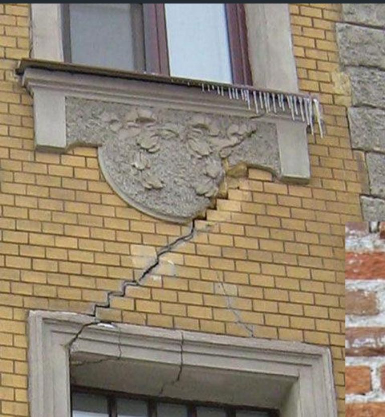
Примеры частичного разрушения кирпичной кладки
