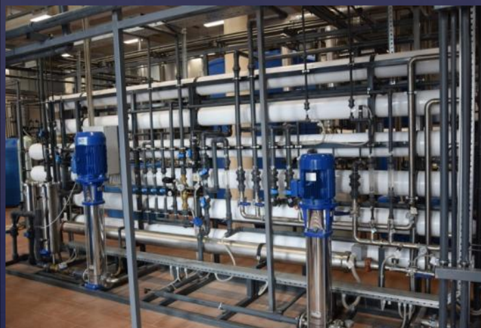
Установка водоподготовки, 35 м 3 /час,
