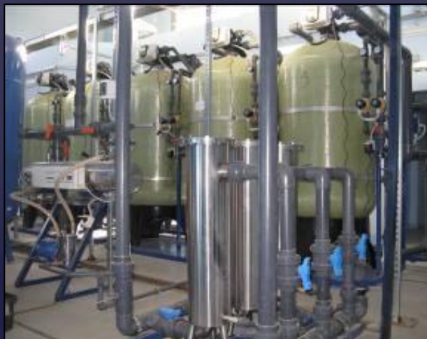
Установка обезжелезивания 100 м 3 /час, пос. Балакирево,
