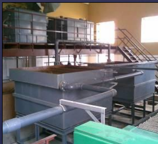
Установка очистки сточных вод пищевого производства, 40 м 3 /час
