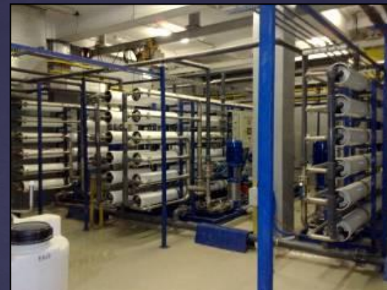
Установка обратноосмотическая, 110 м 3 /час, Калининская АЭС
