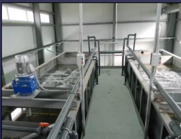
Установка биологической очистки сточных вод, 100 м 3 /час
