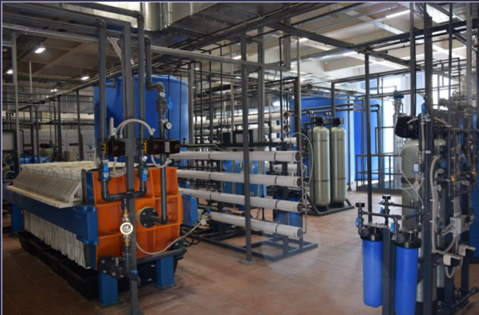
Общий вид установки
