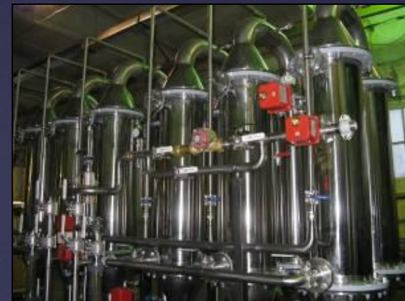
Установка очистки СО 2 на базе керамической УФ, 10 м 3 /час
