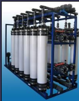
Установка полуволоконной ультрафильтрации, 160 м 3 /час,
