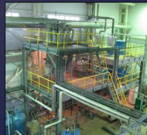
Установка очистки сточных вод гальваники, 24 м 3 /час, ОАО «Северстальавто-Елабуга»
