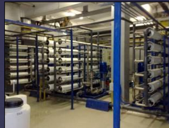
Установка обратноосмотическая, 110 м 3 /час, Калинская АЭС
