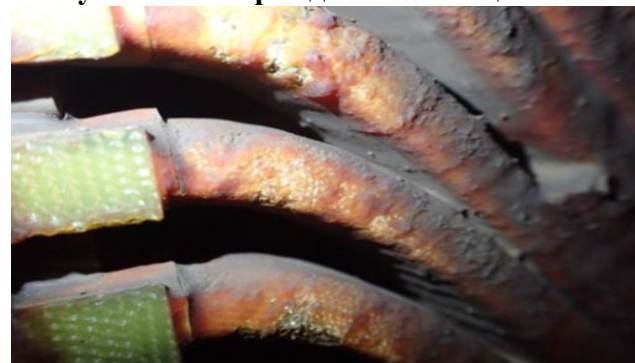
Рисунок 4 - Повреждение изоляции на выходе из паза статорного железа
