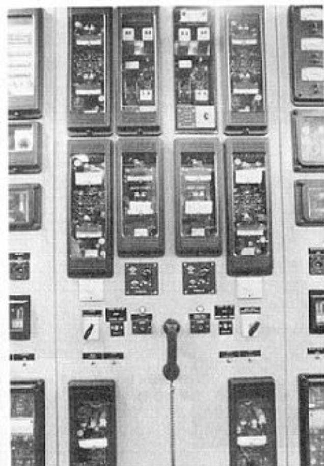
Рис. 2 Типовая панель защиты линии, выполненная на электро-механических реле
