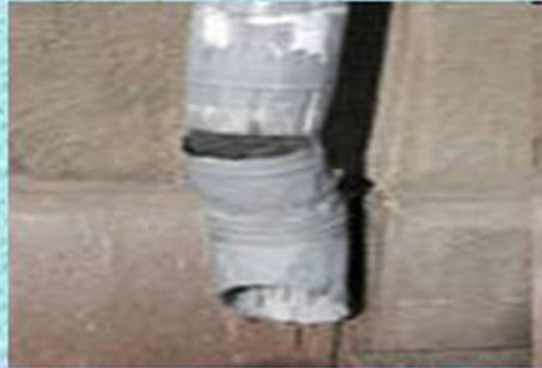
Водосточная труба, разорванная льдом
