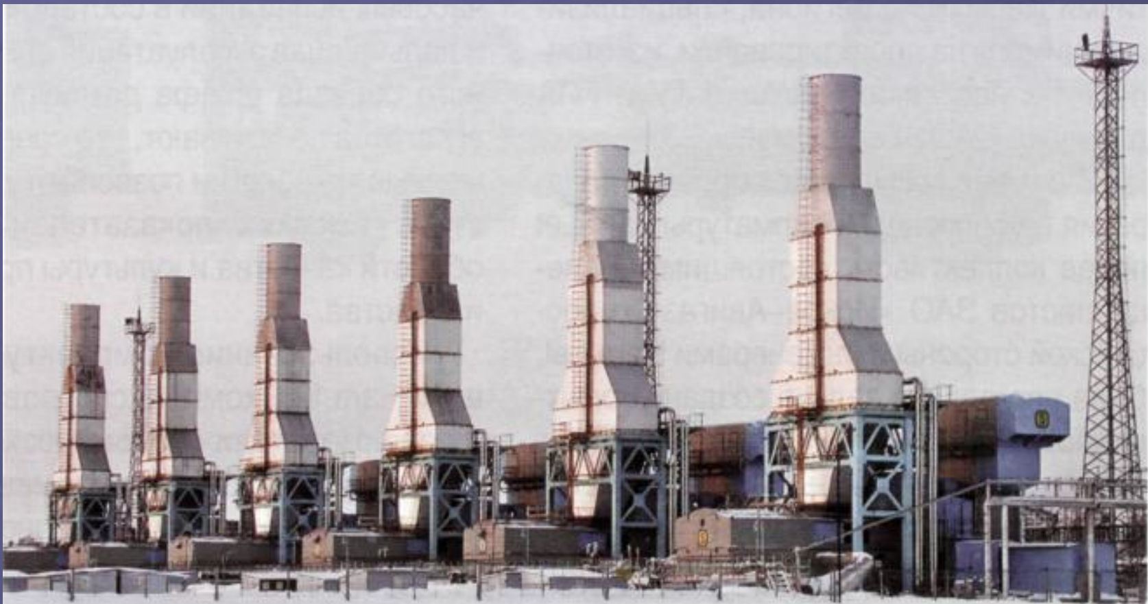
Газотурбинная установка с ВОУ
