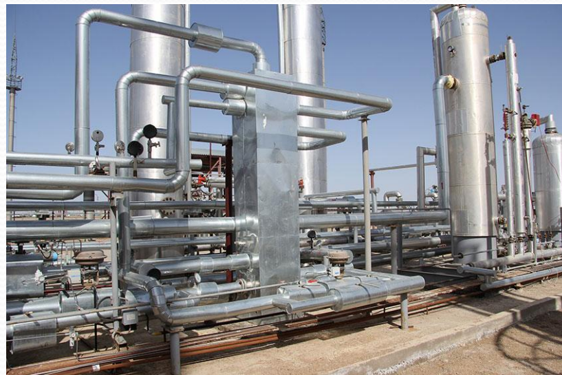
Блок низкотемпературной сепарации
