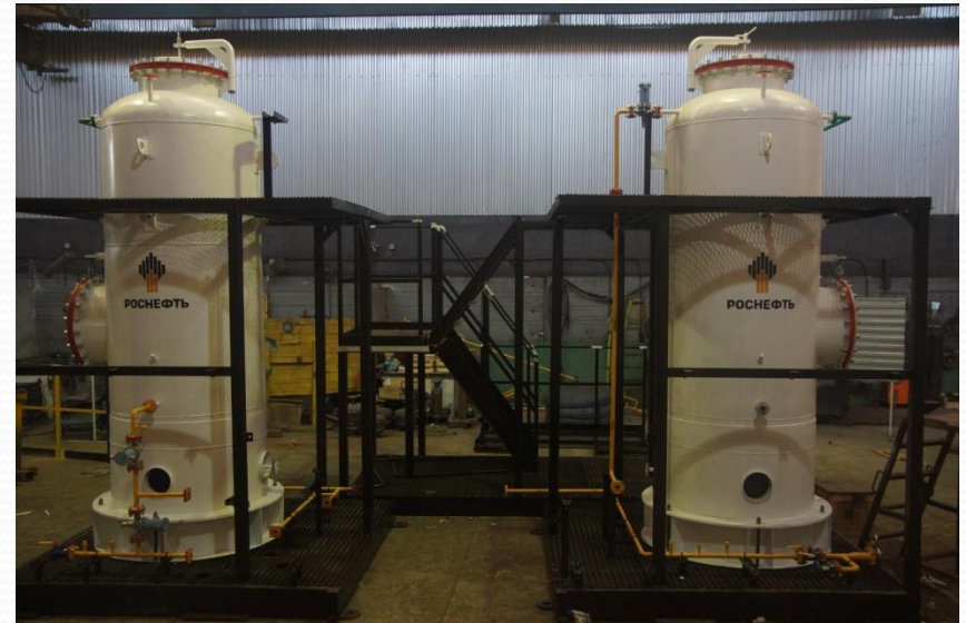
Установка адсорбционной подготовки газа
