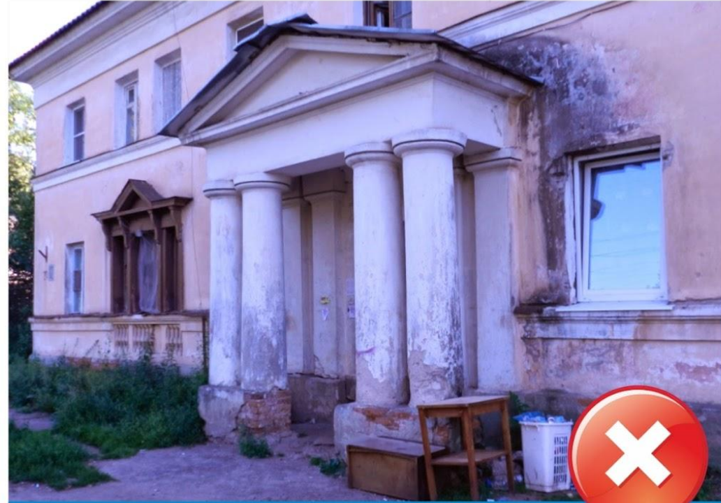
Фасад с повреждениями
