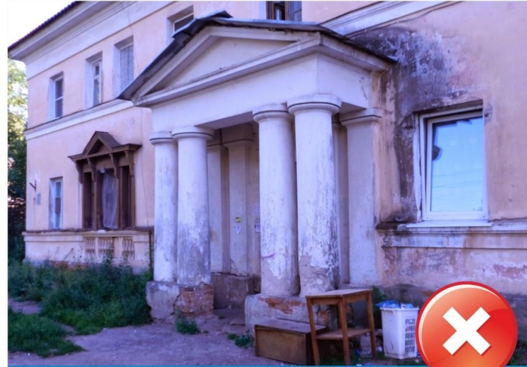
Фасад с повреждениями
