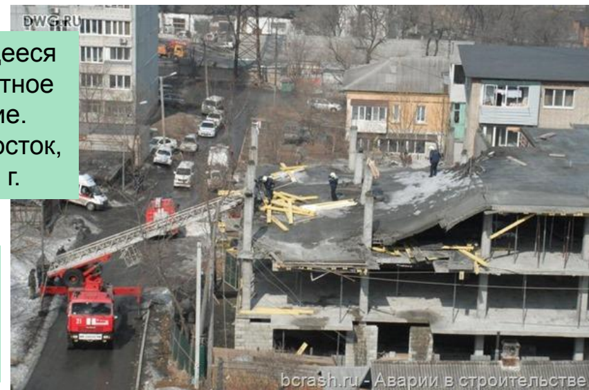
Подземный паркинг. Москва, 2009 г.
