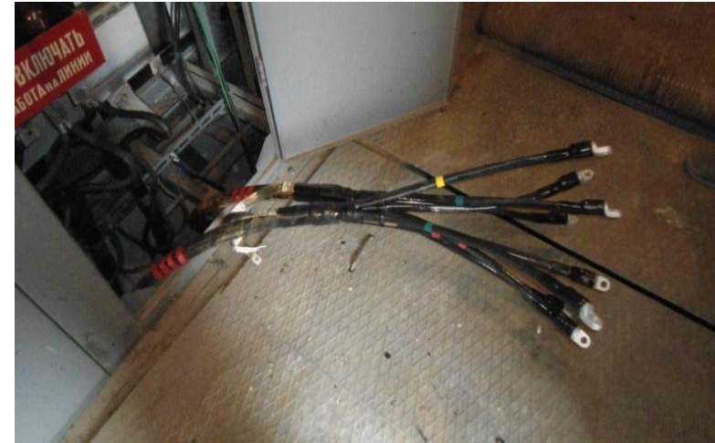
подключение к установкам
