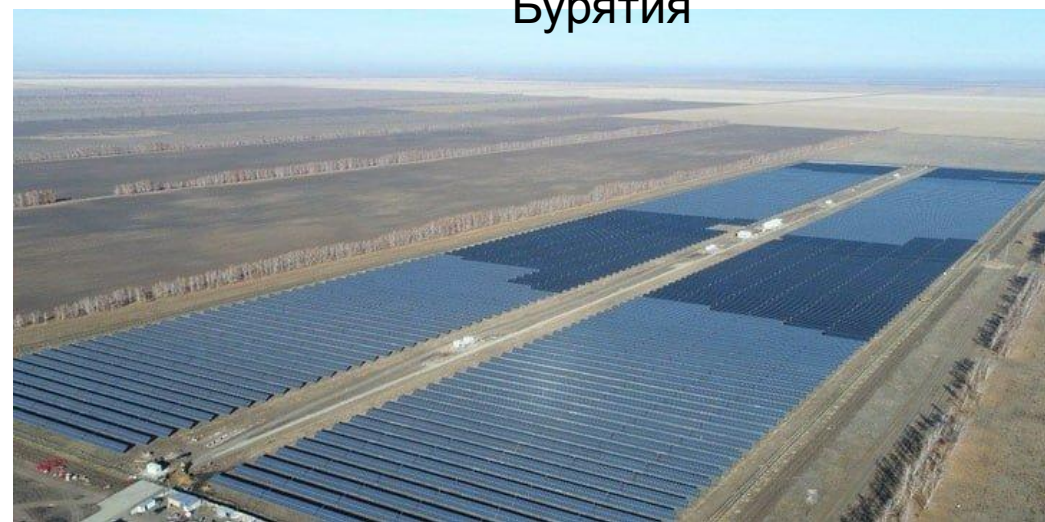
Омск. Солнечная электростанция
