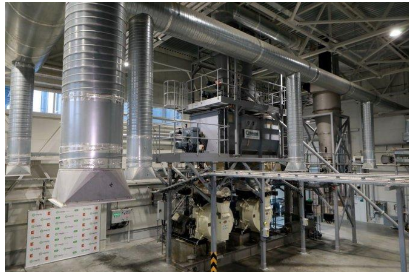
генератор теплоты из отходов
