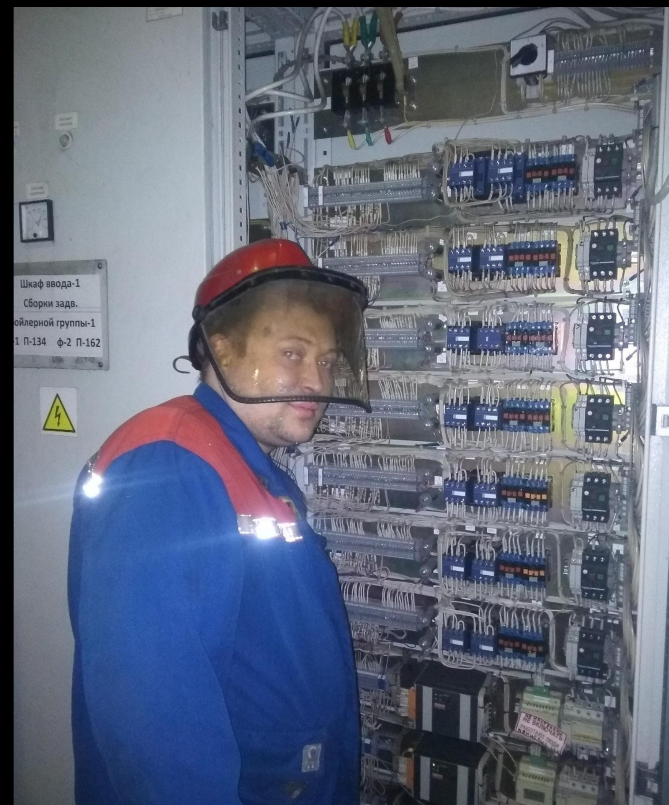
Техническое обслуживание электрической части исполнительных механизмов
