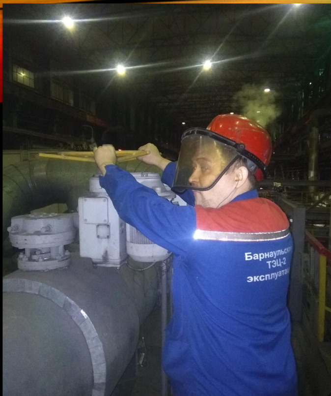
Обслуживание исполнительных механизмов
