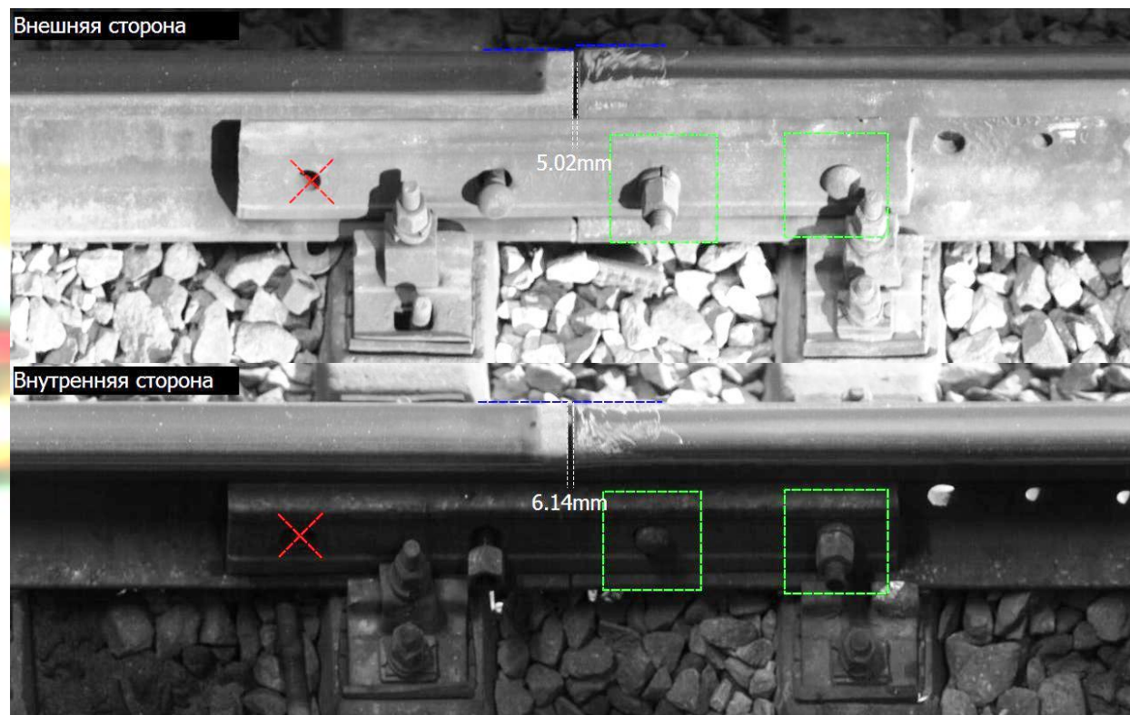
2 болта на 4-х дырной накладке
