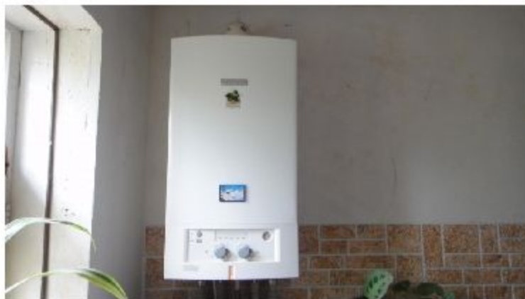
Газовый котел отопления
