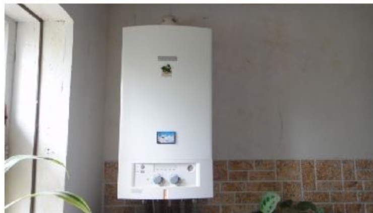
Газовый котел отопления
