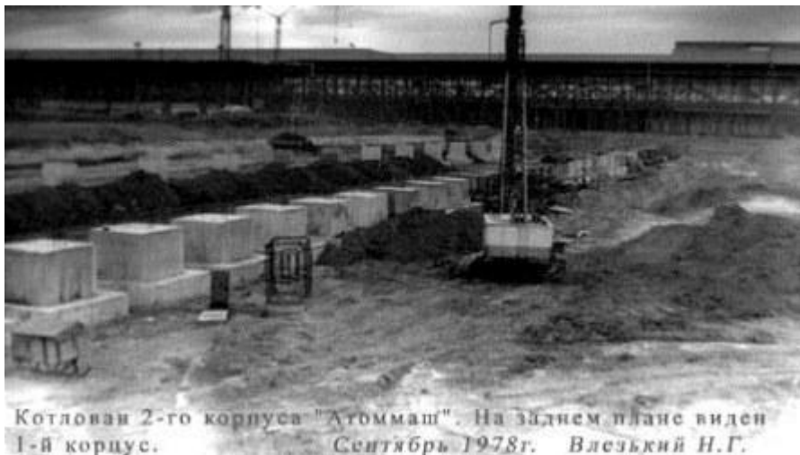
Котлован 2-го корпуса «Атоммаш». На заднем плане виден 1-й корпус. Сентябрь 1978г. Влезький Н.Г. Строительство 2-ого корпуса завода «Атоммаш» .
