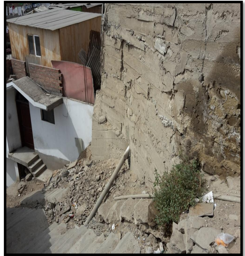
Imagen 26. Escaleras en mal estado y dañadas por el empalme clandestino de agua y desagüe, los cual es un peligro para las personas que transitan usando ese medio. También se puede observar la pared humedecida y probablemente debilitada por escape de agua de estos empalmes de agua.
