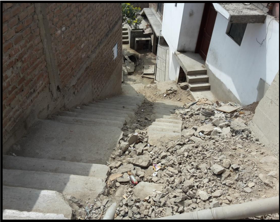
Imagen 27. Escaleras dañada por el empalme clandestino de agua y desagüe, los cual es un peligro para las personas que transitan usando ese medio.
