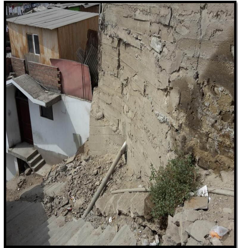
Imagen 26. Escaleras en mal estado y dañadas por el empalme clandestino de agua y desagüe, los cual es un peligro para las personas que transitan usando ese medio. También se puede observar la pared humedecida y probablemente debilitada por escape de agua de estos empalmes de agua.
