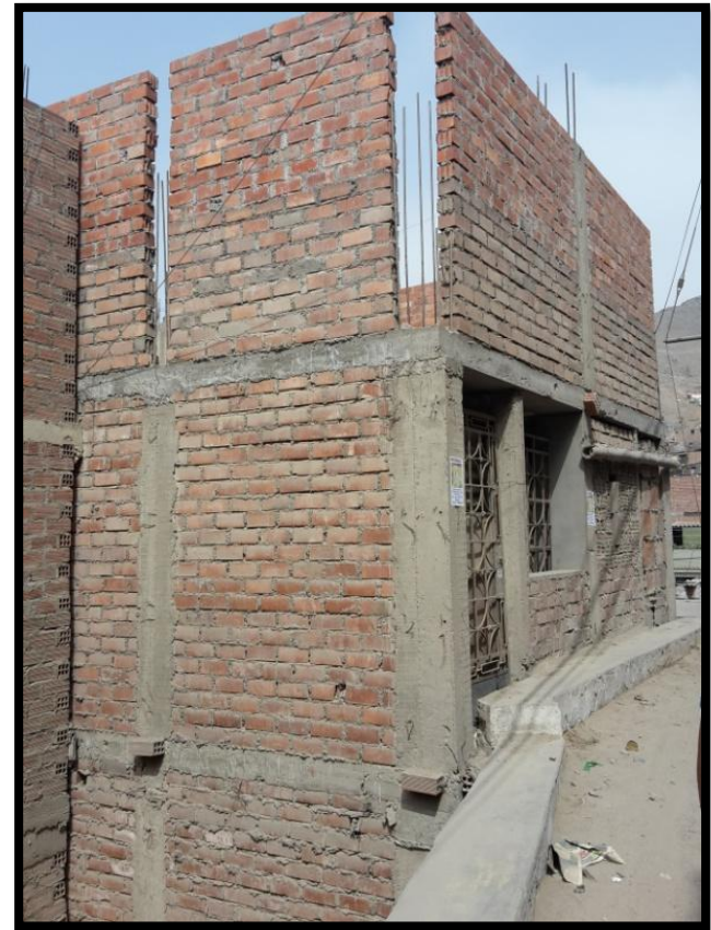
Imagen 32. Informalidad en la construcción y falta de medidas de seguridad, esto queda evidenciado en la pared, ya q esta no se encuentra amarrada a la columna. Falta de señalización o alguna medida de control contra posibles accidentes (muro de unos 6 metros de caída)
