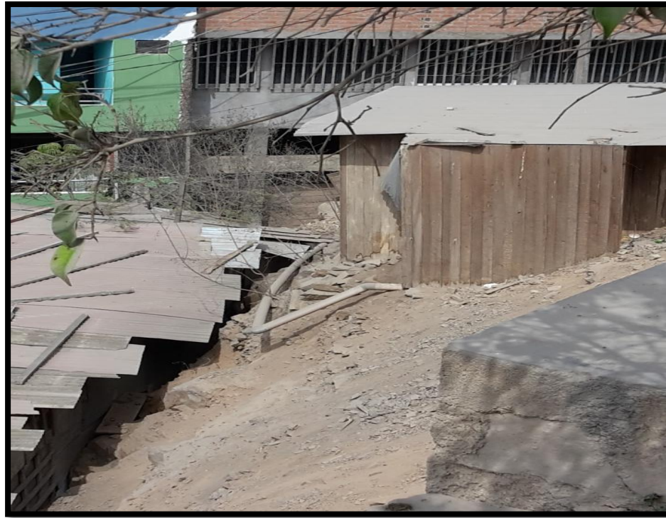
Imagen 28. Conexión clandestina de desagüe, exponiendo la salud de la población.
