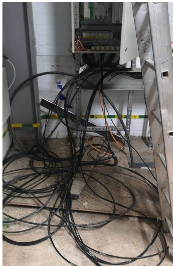
ПКУ – 12: Силовые кабели не подключены
