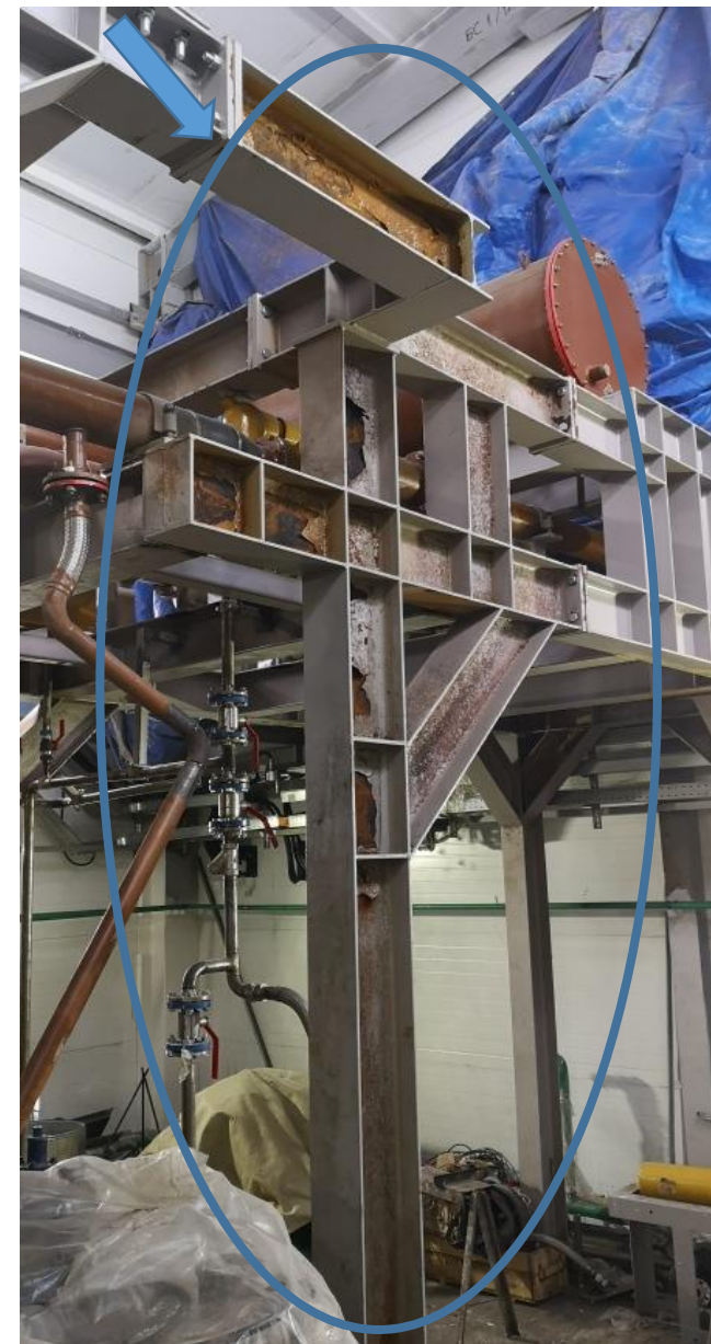
ПКУ – 12: Требуется нанесение дополнительного АКЗ на м/к
