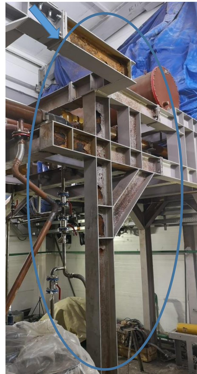
ПКУ – 12: Требуется нанесение дополнительного АКЗ на м/к
