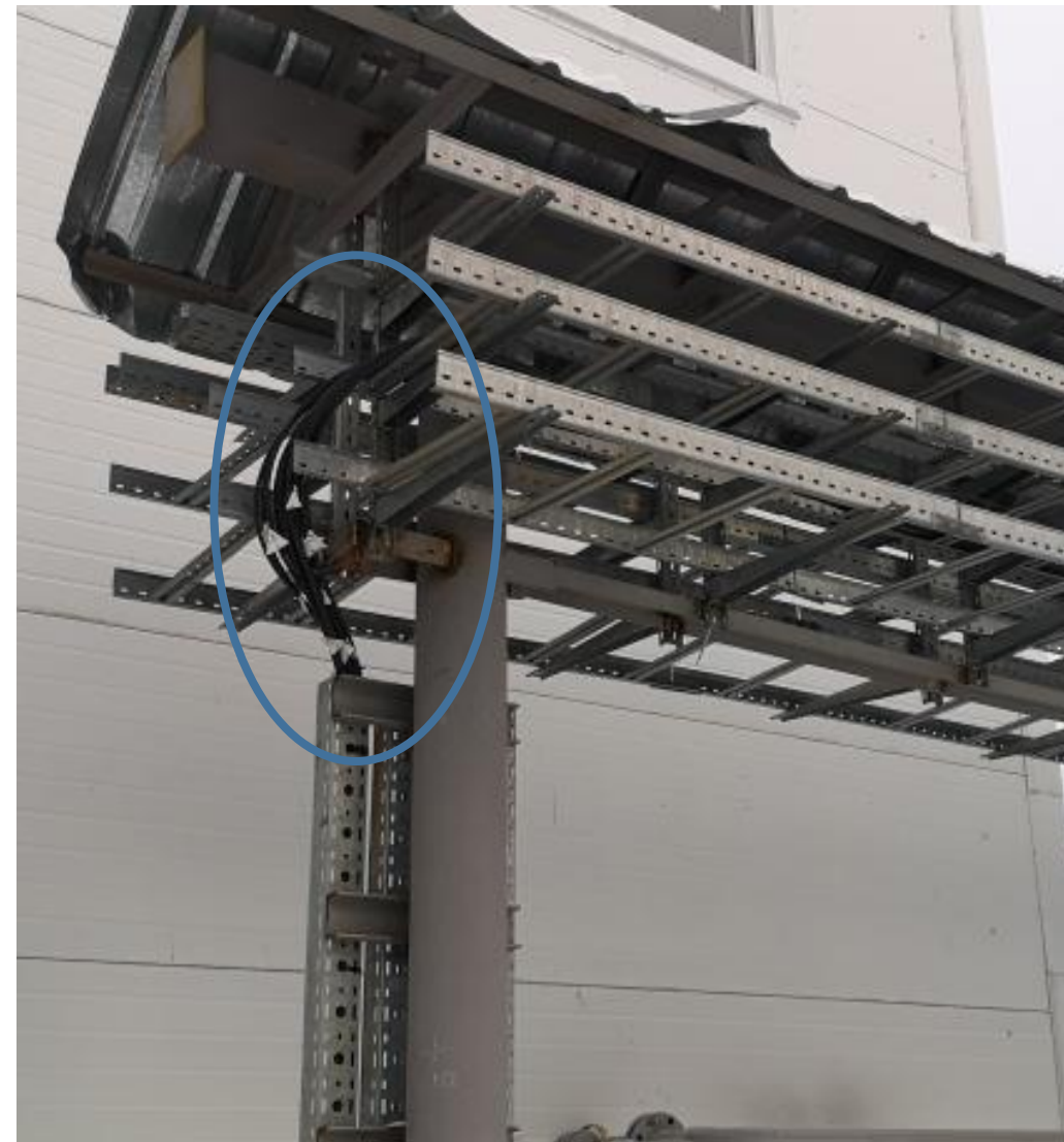
Электротехническая эстакада к ПКУ11 (между ПКУ11 и ПКУ10)
