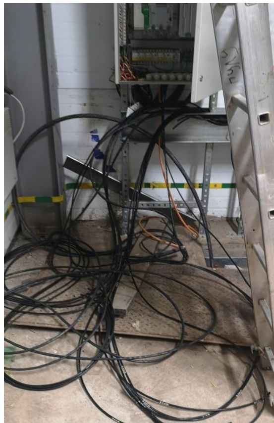
ПКУ – 12: Силовые кабели не подключены
