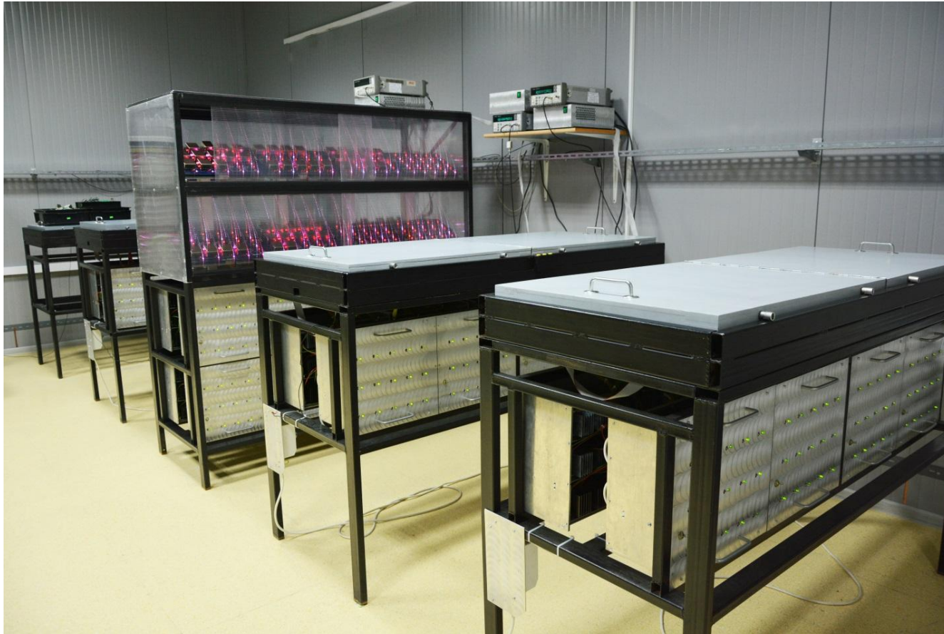
Помещение и стойки контроля ДНЧ
