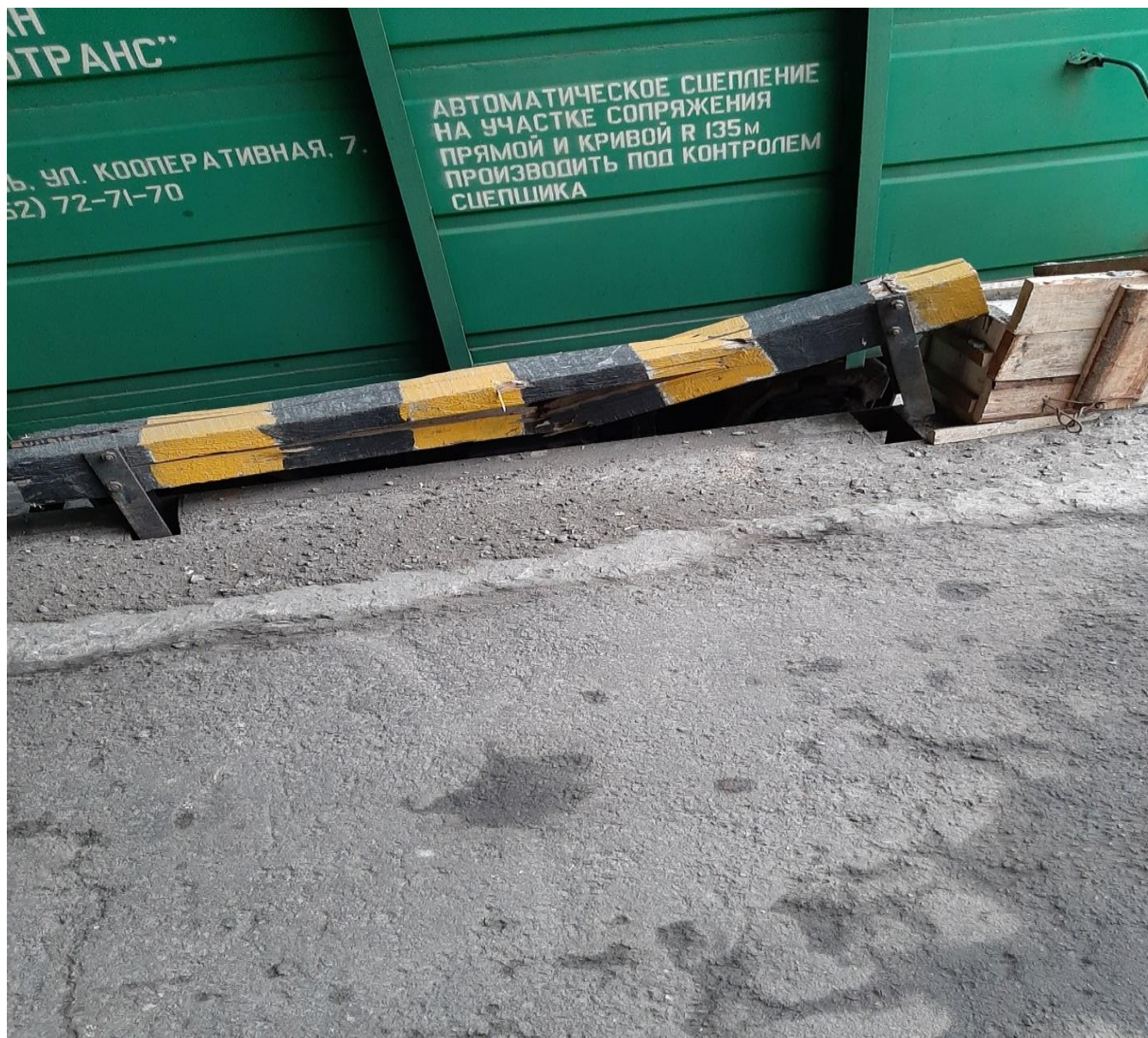
Повреждение колесоотбойного бруса.
