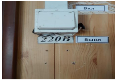
Провода лишние торчат.
