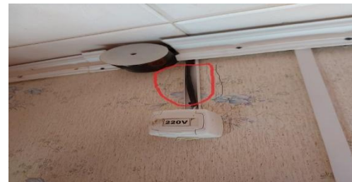
Не закрыты кабельные каналы в жилых вагончиках
