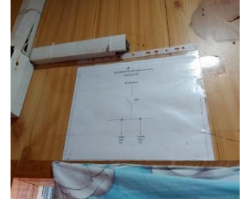
Кабель каналы не закреплены.
