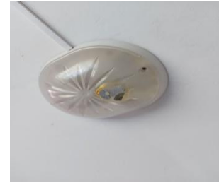
Плафон светильника в негодном состоянии.
