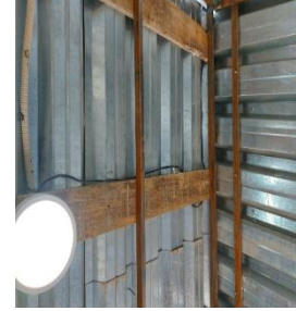
Провода освещения без гофры.
