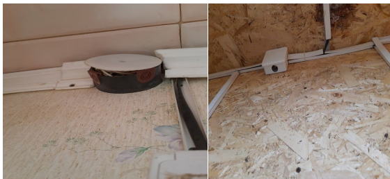
Повреждённые электрораспределительные коробки
