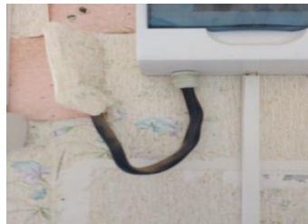
Кабель канал отсутствует.
