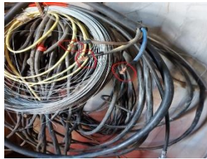
Не понятные кабели не изолированные.
