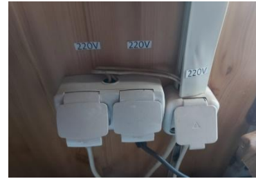
Провода розеток без кабель каналов.
