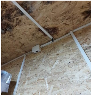
Кабель каналы не закрыты.
