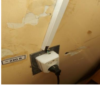
Розетки не закреплены.
