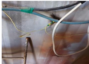
Заземляющие провода не закреплены.
