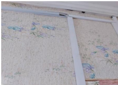
Кабель каналы не закрыты.
