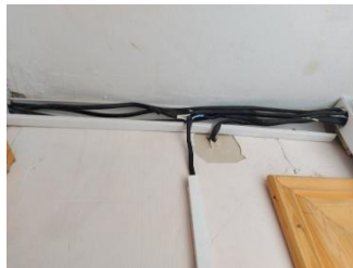
Кабель не закрыты в кабель каналах.
