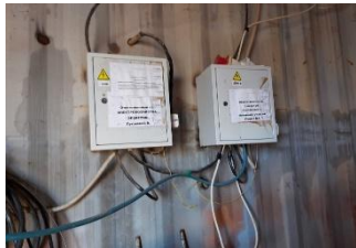
Укладка кабелей не у порядочная.
