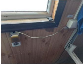
Провода розеток без кабель каналов.
