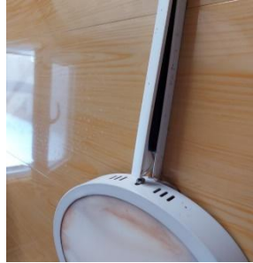
Кабель канал не закрыт.
