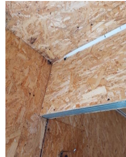
Кабель каналы не закрыты.
