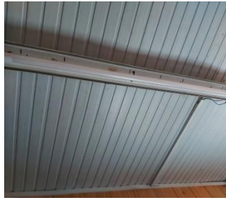
Нету защитного плафона светильника ЛБ40.
