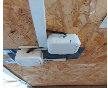
Не закрыты кабель каналы.
