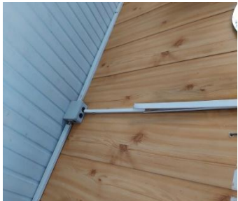
Кабель каналы не исправны.
