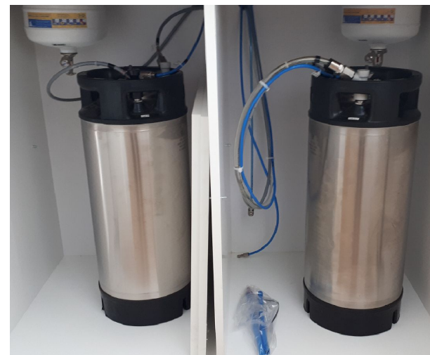
Баллоны под давлением
