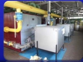
Оборудование котельной Соцгородок г. Валуйки
