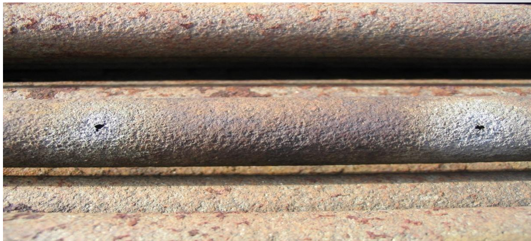
Сквозные коррозионные поражения стенки трубы по внутренней поверхности (материал Ст. 15ХМ)
