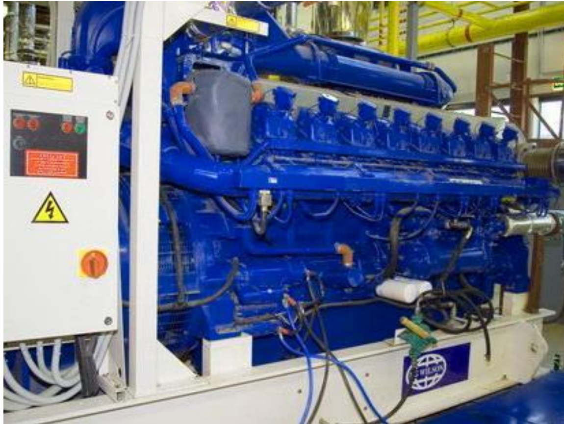
Генератор на електростанци
