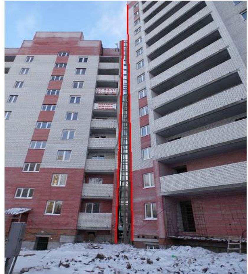
Рис.13 Зазор между 14 - и 9-этажной секцией
