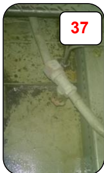
в районе фильтра тонкой очистки
