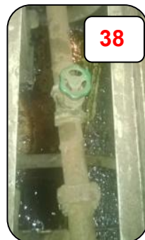
в районе водомасляного теплообменника
