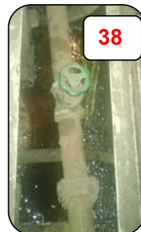
в районе водомаляного теплообменника
