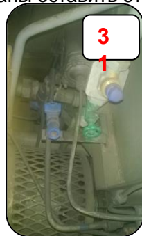
в районе компрессора КТ-7 с гидроциклона
