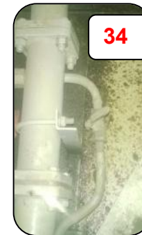
в районе санузла
