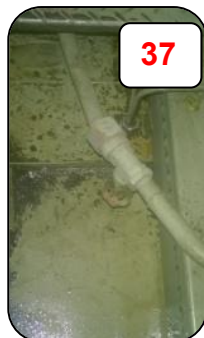
в районе фильтра тонкой очистки
