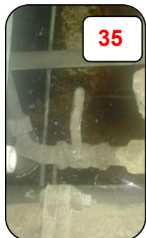
в районе водомаляного теплообменника
