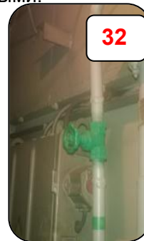
в районе компрессора КТ-7 с гидроциклона
