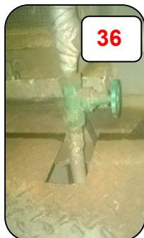
в районе санузла
