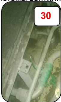
в районе топливо- подкачивающего насоса
