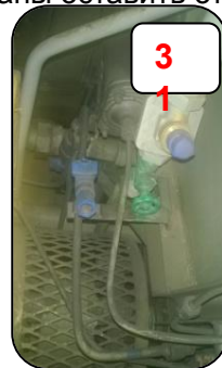
в районе компрессора КТ-7 с гидроциклона
