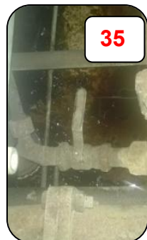
в районе водомасляного теплообменника
