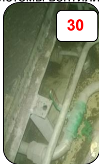
в районе топливо-подкачивающего насоса
