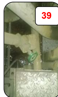
в районе водомаляного теплообменника
