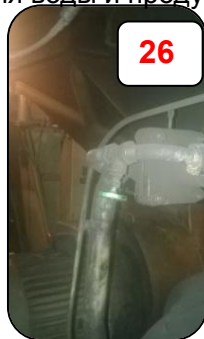
в районе турбокомпрессора с расширительного бака
