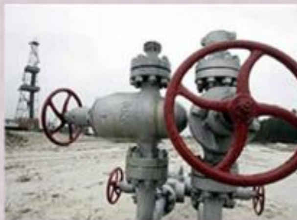
в системах газоснабжения
