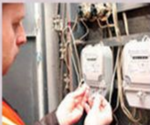
в системах энергоснабжения
