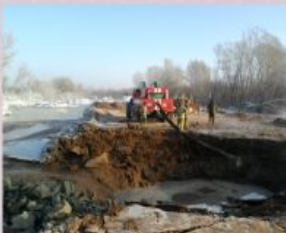
в системах канализации
